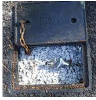
散水栓の蓋開ける
