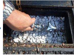
散水栓と接続
